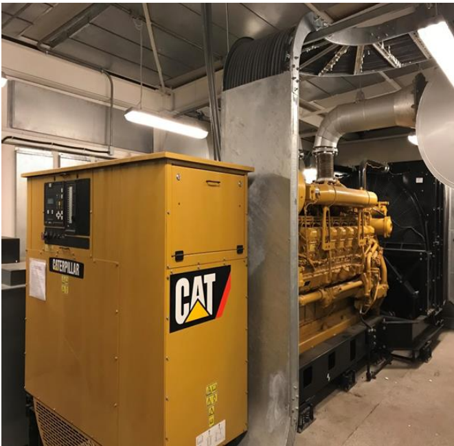
Grupo Electrónico Piso Mecánico Edificio D.
